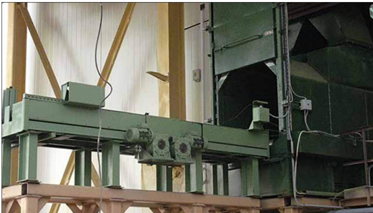
Рисунок 1 – Агрегат термического обезвреживания, вид снаружи здания 1001П (март 2017 г., фотография авторов)
