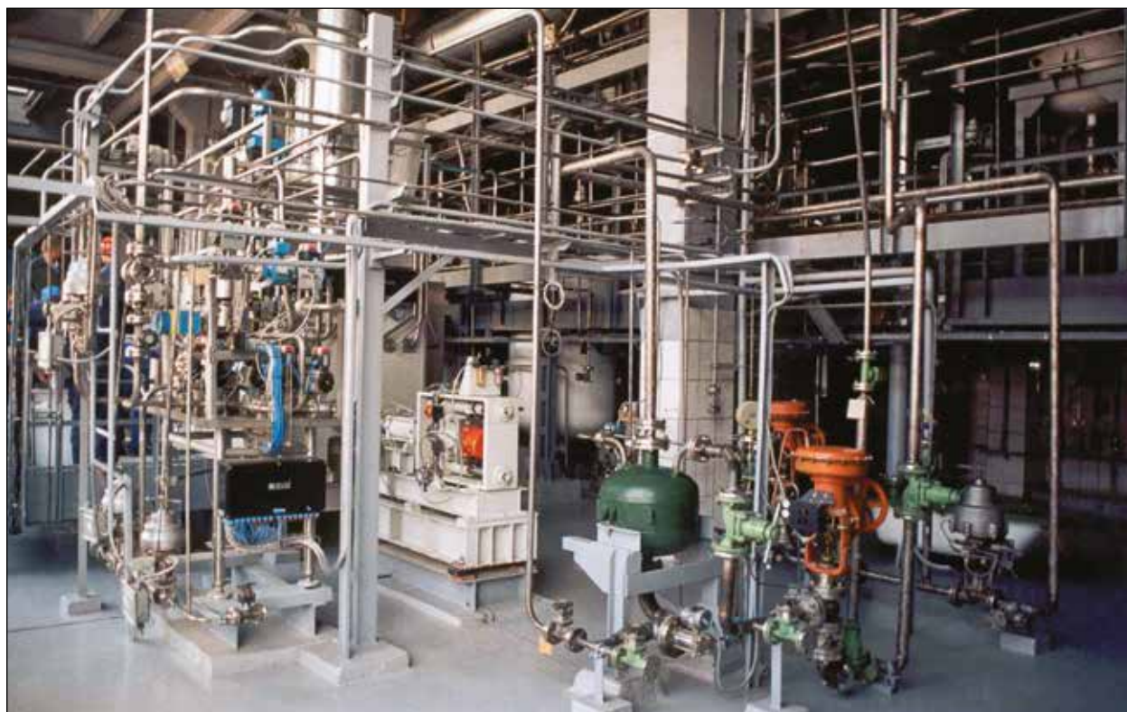
Рисунок 8 — Линия по уничтожению плутона на объекте «Горный» (Саратовская область) 1
